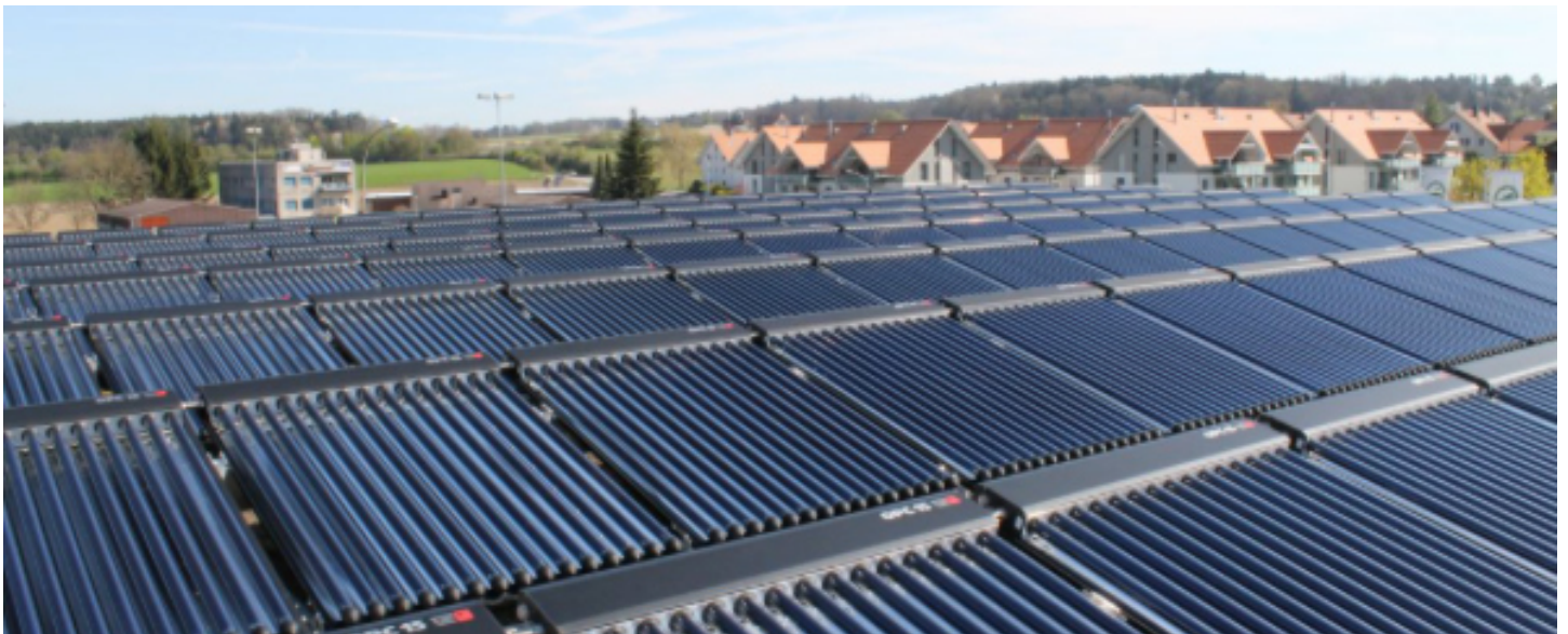
Der Wärmeverbund in Schüpfen (BE) ist einer von wenigen in der Schweiz, der Solarwärme für ein Wärmernetz heranzieht. Der Wärmeverbund versorgt gegenwärtig neun Gewerbebetriebe und 630 Wohnungen mit Wärme, die aus einer Holzschnitzelheizung und einer Solarthermie-Anlage mit 460 m 2 Kollektoren stammt. Foto: Wärmeverbund Lyssbach Schüpfen AG
