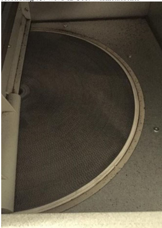
Abbildung 75: WNG ID 510: Wärmetauscher
