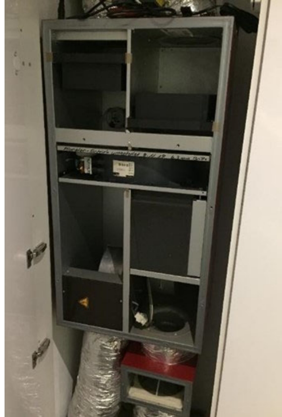
Abbildung 87: WNG ID 610: Lüftungsgerät
