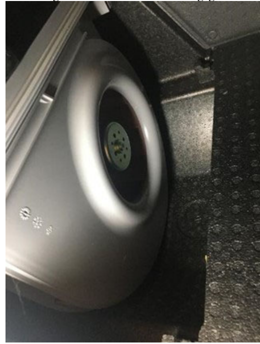
Abbildung 105: WNG ID 810: Lüftungsgerät
