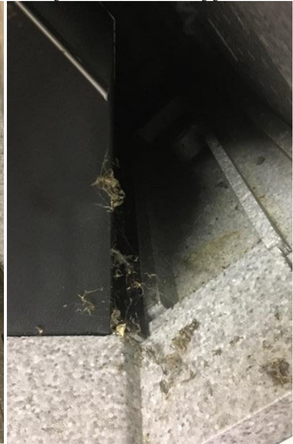
Abbildung 128: WNG ID 1010: Lüftungsgerät
