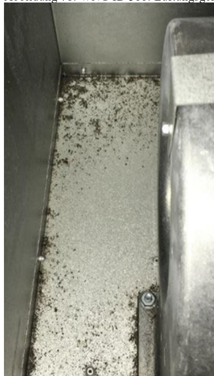
Abbildung 76: WNG ID 510: Lüftungsgerät
