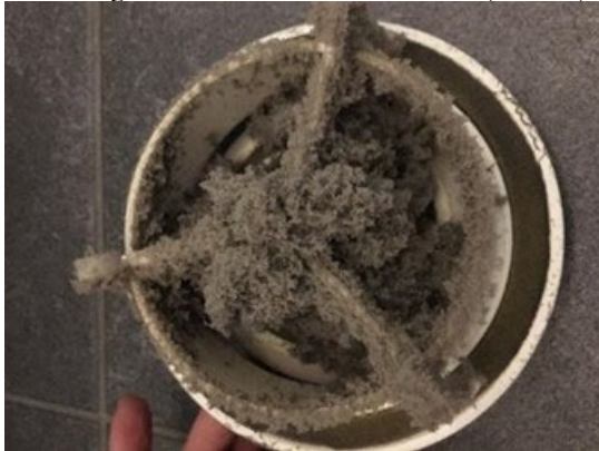
Abbildung 49: WNG ID 310: ABL-Ventil (Dusche)
