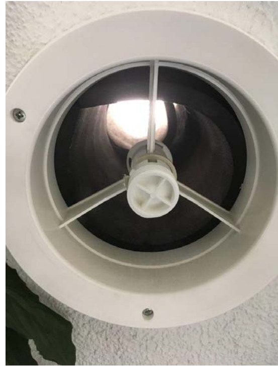
Abbildung 214: WNG ID 920: Zuluftkanal
