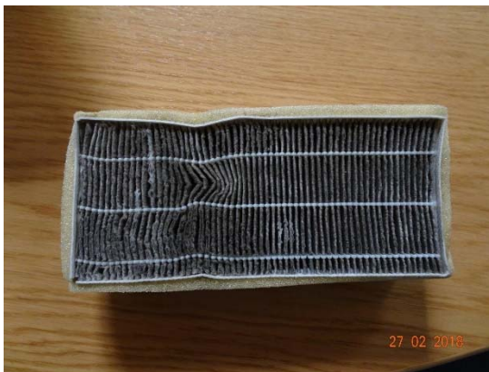
Abbildung 220: WNG ID 1010: Zuluftfilter
