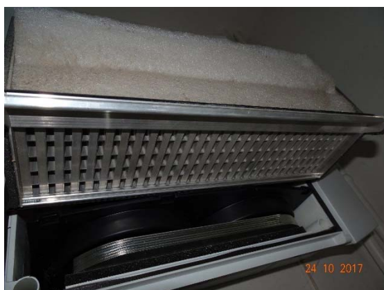
Abbildung 67: WNG ID 310: Wärmetauscher
