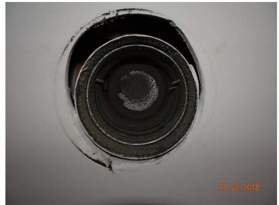
Abbildung 150: WNG ID 710: ABL-Rohr, Bad
