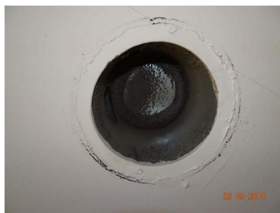
Abbildung 179: WNG ID 730: ABL-Rohr, Bad
