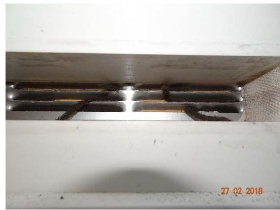
Abbildung 157: WNG ID 720: Durchbruch AUL v.I.
