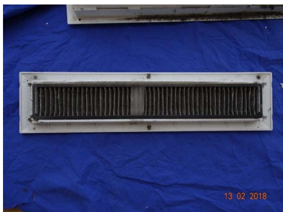
Abbildung 118: WNG ID 520: AUL-Filter, eingebaut
