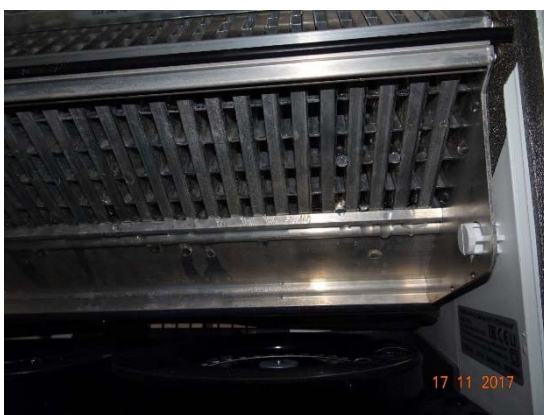
Abbildung 45: WNG ID 210: Wärmetauscher
