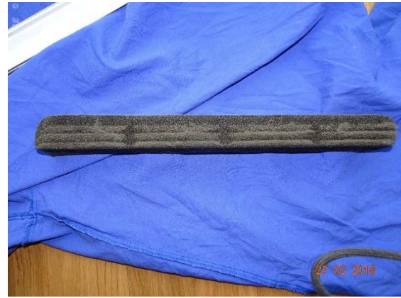
Abbildung 146: WNG ID 710: Zuluftfilter
