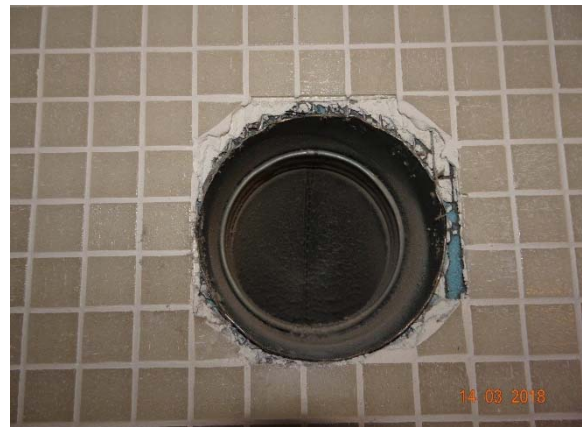
Abbildung 188: WNG ID 810: ABL-Rohr, Bad
