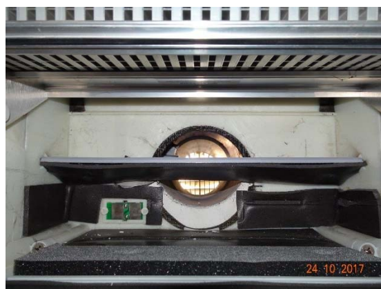
Abbildung 68: WNG ID 310: Lufteintritt in Gerät
