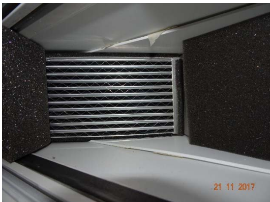
Abbildung 25: WNG ID 110: Wärmetauscher
