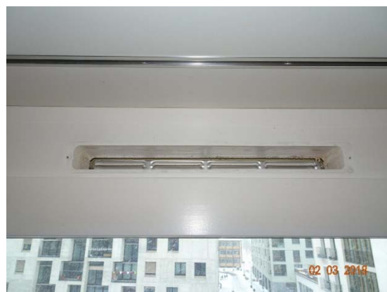
Abbildung 177: WNG ID 730: Durchbruch AUL v.I.
