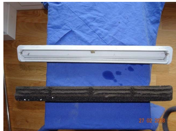
Abbildung 155: WNG ID 720: Zuluftfilter
