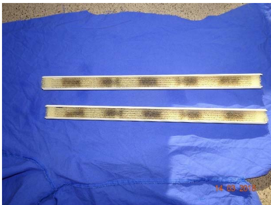
Abbildung 199: WNG ID 830: Zuluftfilter
