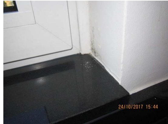
Abbildung 79: WNG ID 320: ev. Schimmelablagerung
