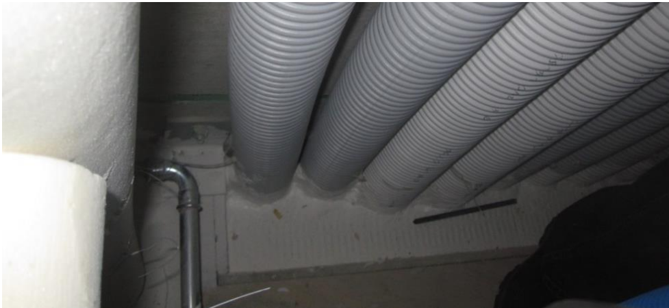
Figura 8 Vano tecnico verticale (Fonte: Hochschule Luzern – Technik & Architektur; Foto: 30.11.2013)
