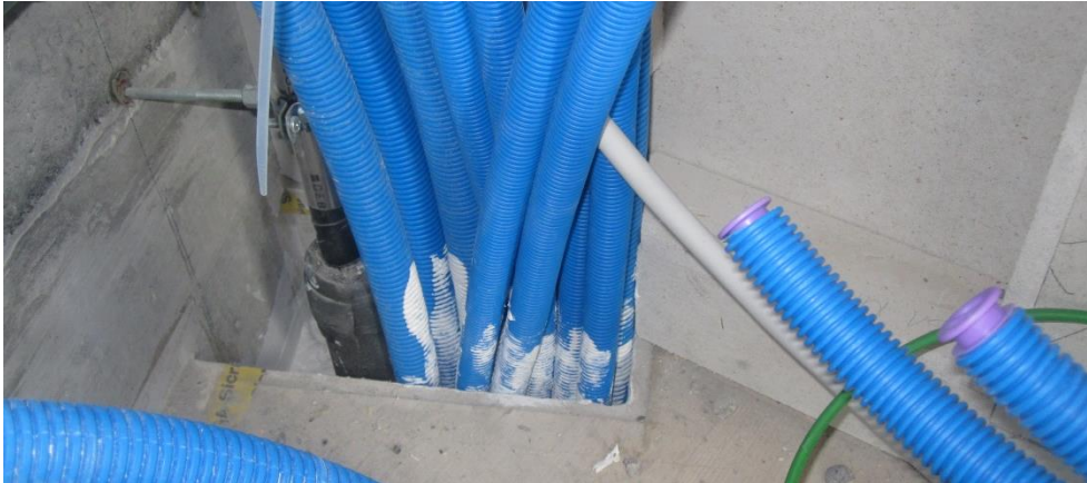
Figura 9 Non idoneo: Fascio di installazioni elettriche (Fonte: Hochschule Luzern – Technik & Architektur; Foto: 30.11.2013)
