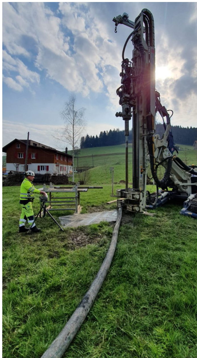
Les sondes géothermiques sont posées à une profondeur de 50 à 300 mètres. Ils sont constitués de tuyaux en plastique parallèles dans lesquels circule un mélange d'eau et d'antigel (saumure). Photo: LSS Bohr AG
